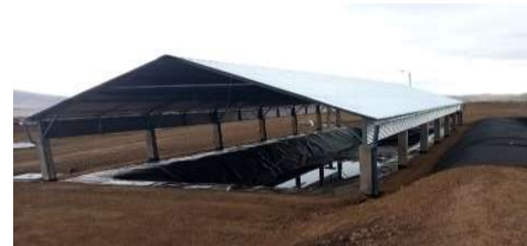
Poza de Lixiviados
